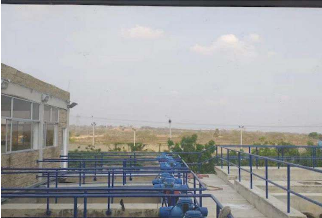
Robo de agua en acueducto ManatíCandelaria
